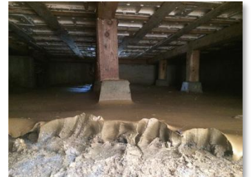
Bùn đang đọng lại dưới sàn nhà đang rỉ ra
