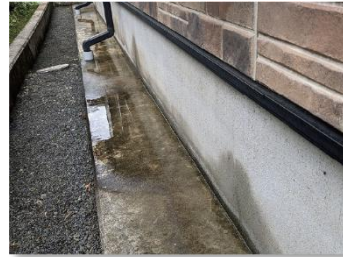
Không có mưa nhưng nước lại đang rỉ ra
