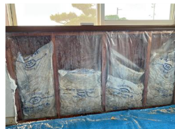
墙壁背面的隔热材料仍处于潮湿状态
