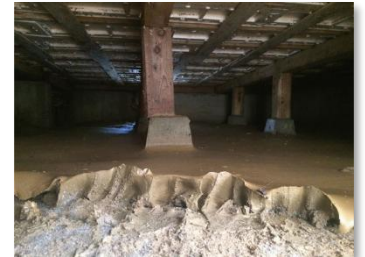
地板下方积满了泥土
