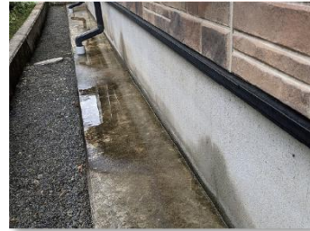
明明没有下雨，水却渗了出来
